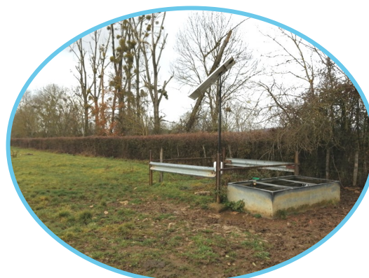
Abreuvoir solaire, Guillon-Terre-Plaine, 2018
